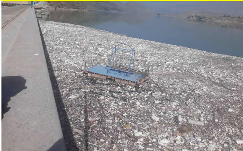
تاج سد لتیان و وجود زباله در روی سطح آب
